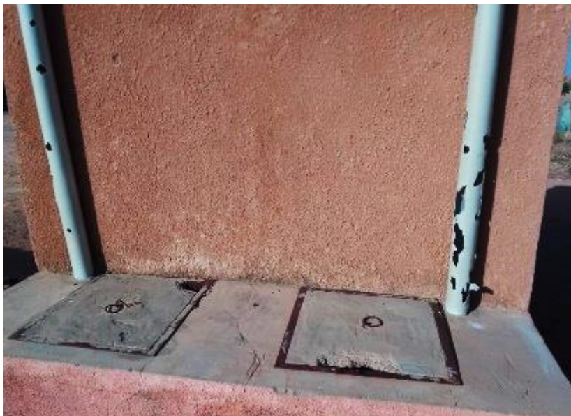
Figure 11 : Images de la tuyauterie à réhabiliter
